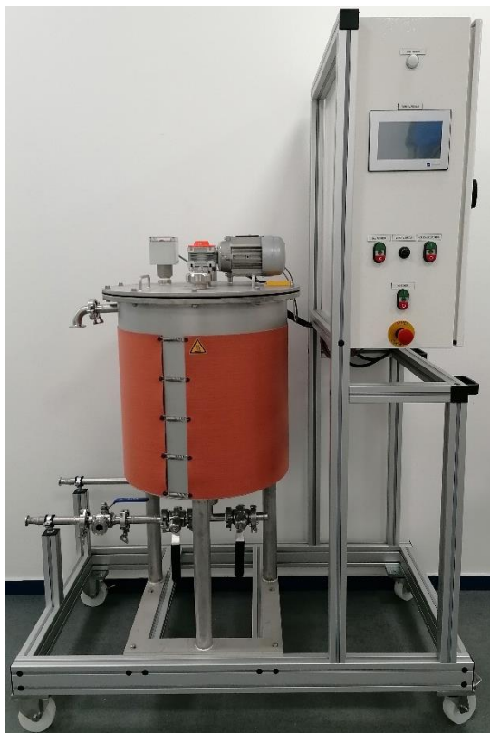
Photo cuve de stockage
