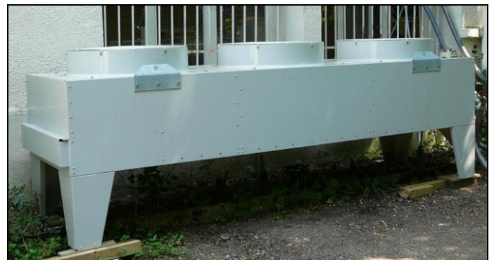
Aérotherme de dissipation
