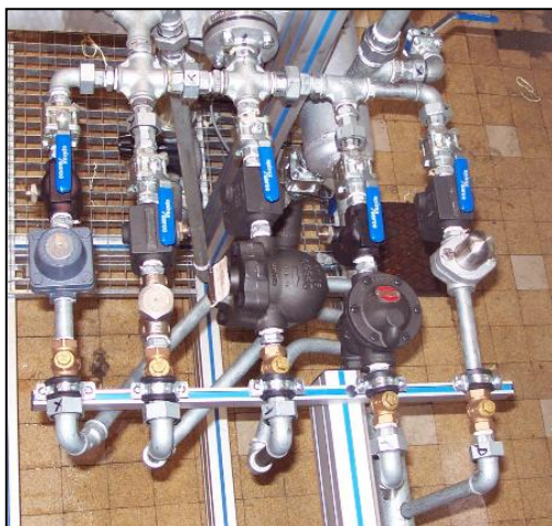
Ligne d'essai de purgeurs
