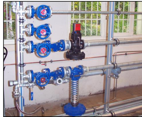
Ligne d'essai de détendeurs
